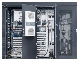
Електрична шафа з клімат-контролем, зручна для доступу, ізольована від джерел тепла.
